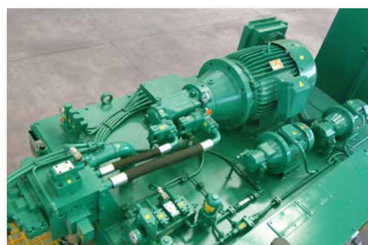
Dettagli della centrale idraulica Details of hydraulic power unit
